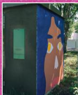
Poste ENEDIS rue Terre de Vîmes
