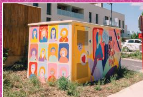
Poste ENEDIS avenue de Soulac
